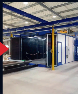
Cabine de sablage
